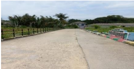
Gambar 1. Jembatan di Masyarakat Pesisir Pantai RW.14 Kelurahan Tanjung, Pencapaian Hasil Program KOTAKU
